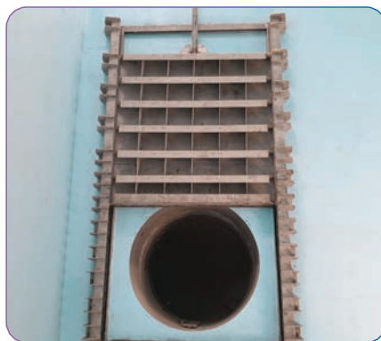
Nhà máy xử lý nước sạch Dĩ An
