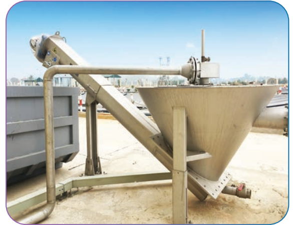
Nhà máy xử lý nước thải
