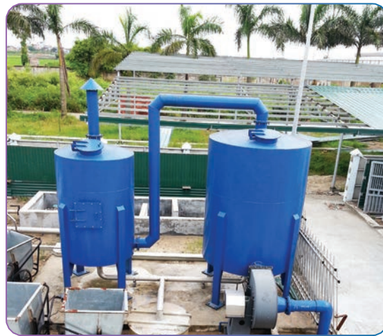
💧 Dự án xử lý nước thải và khí thải cho nhà máy thực phẩm Đan Phượng, Hà Nội
