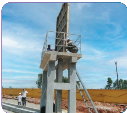
Nhà máy xử lý nước mặt Bắc T.Long
