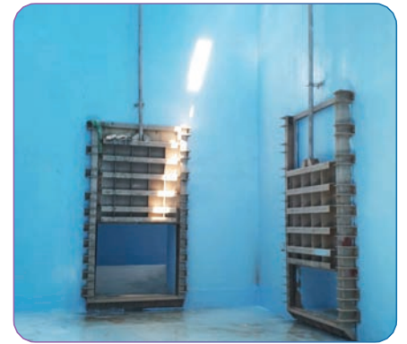
Nhà máy xử lý nước sạch Tân Hiệp
