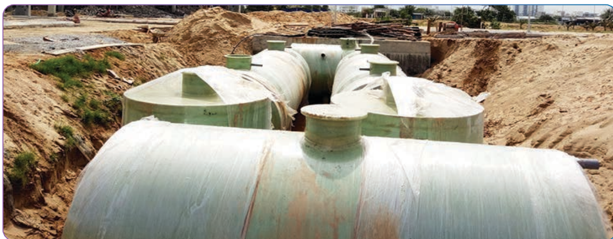
💧 Cung cấp và lắp đặt hệ thống xử lý nước thải hợp khối cho dự án Điện hạt nhân, tỉnh Ninh Thuận
