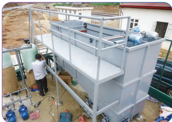
Nhà máy nước thải Ga Lào Cai
