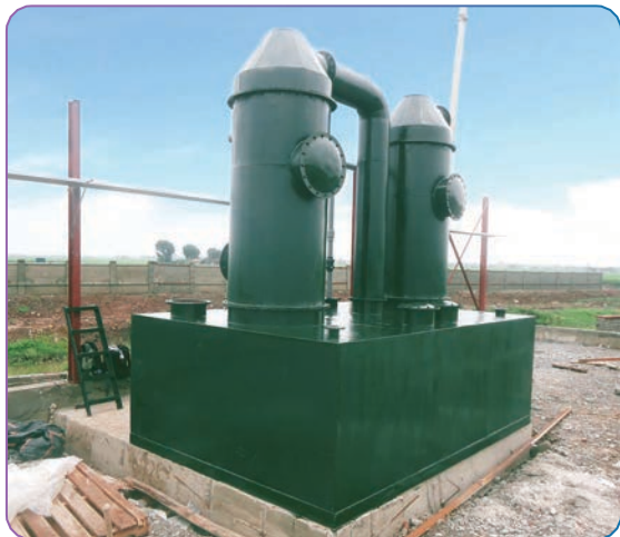
💧 Cung cấp và lắp đặt hệ thống khử mùi cho dự án xử lý nước thải thành phố Ninh Bình
