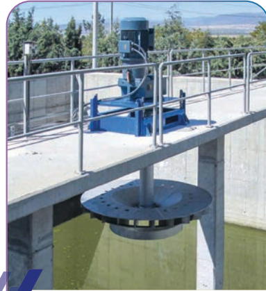
Thiết bị sục khí bề mặt
