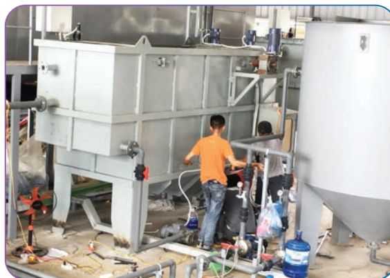
Nhà máy xử lý nước thải Hưng Yên
