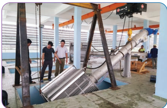
💧 Dự án nhà máy xử lý nước thải Sông Công, tỉnh Thái Nguyên
